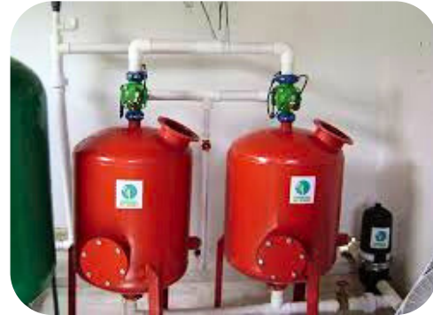
Filtros de arena
