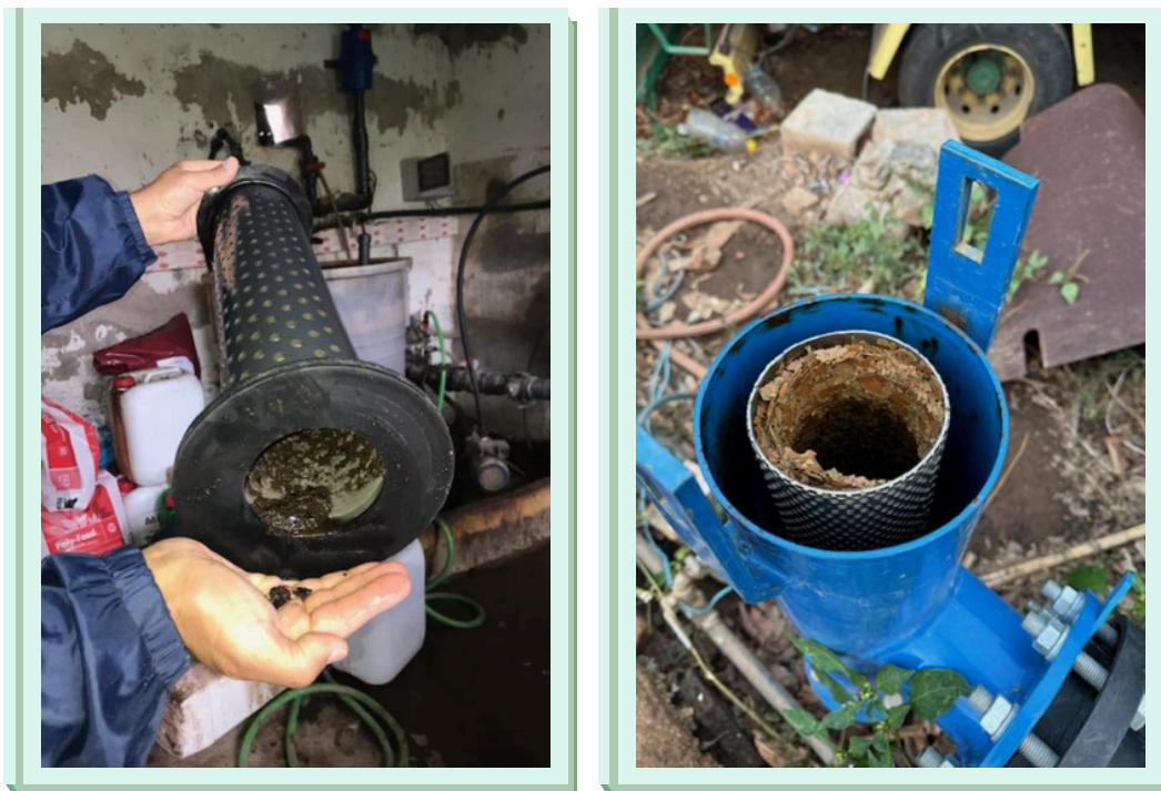
Suciedad acumulada dentro de los filtros de malla
